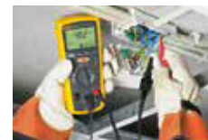
Verdrahtungsprüfung in einem kleinen Verteilerschrank
