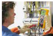
Isolationsprüfung an einer Unterverteilung
