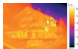
Wärmebild ohne testo ScaleAssist
